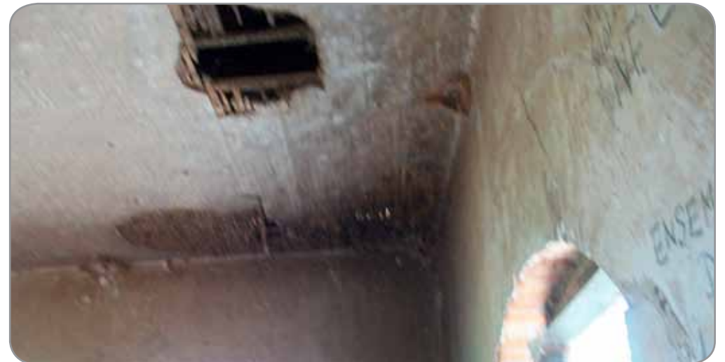
Plafonds à réparer
